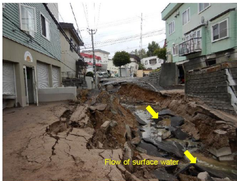
(b) 盛土末端部の土砂噴出状況
