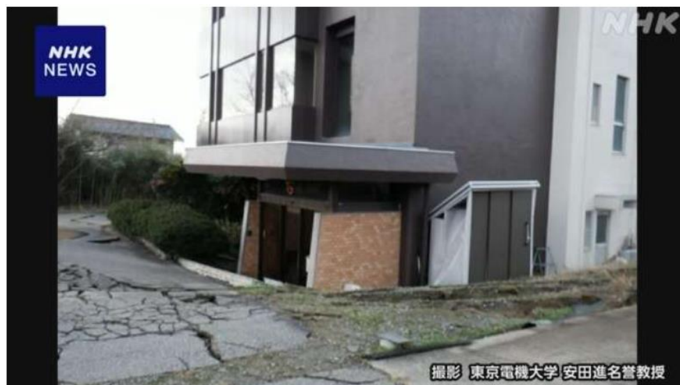
写真 1-6 内灘町での液状化による被災状況 18)
