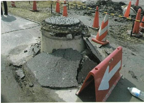
(a) 千葉県浦安市の被災状況
