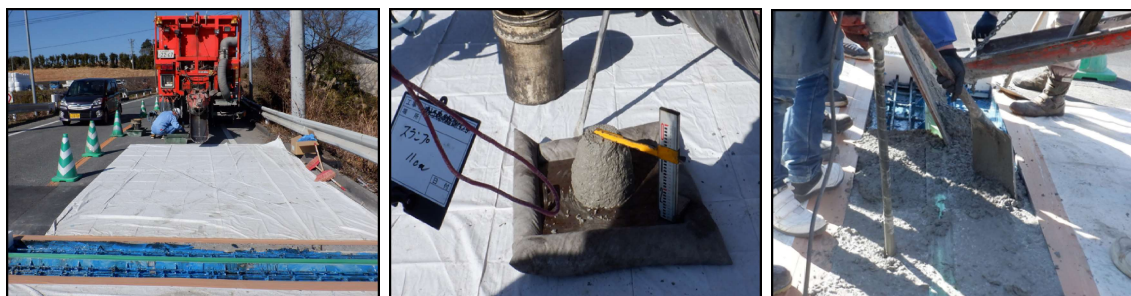
(1) 移動式プラント (ジェットモービル)
