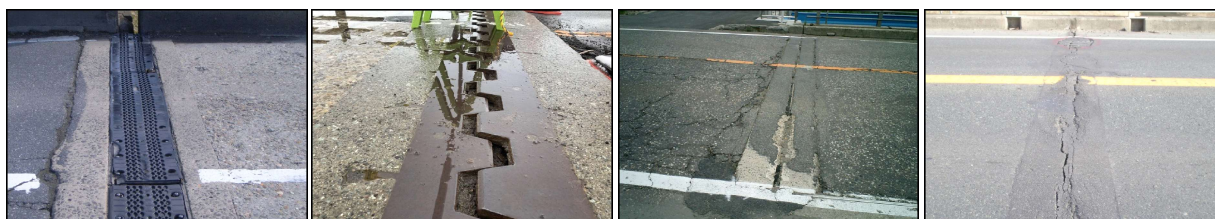
(1) 荷重支持型（ゴム） (2) 荷重支持型（鋼製） (3) 突合せ型 (4) 埋設型 写真－ 2.3 伸縮装置の損傷事例
