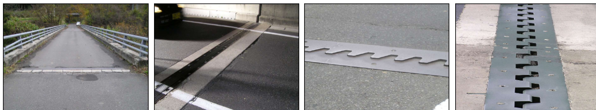
(1) 橋梁と取付道路の段差 (2) 径間部の段差 (3) 伸縮装置の段差
