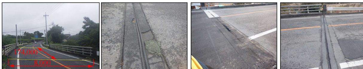
(1) 橋梁の全景 (2) 伸縮装置の損傷 (3) 遊間部の損傷 (4) 舗装部の損傷
