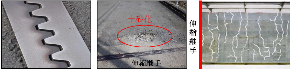
(1) 伸縮装置の段差 3.5) (2) 橋面の損傷（土砂化） 3.5) (3) 下面の損傷 3.6)
