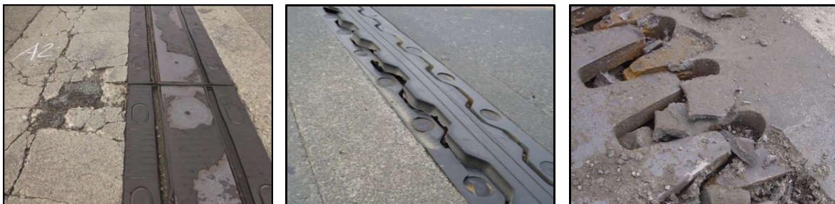
(1) 健全性 III の損傷 3.5), 3.7) (2) 健全性 III の損傷 3.5), 3.7) (3) 健全性 IV の損傷 3.5), 3.7)
