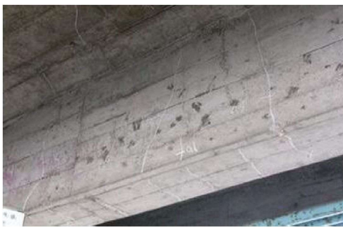
(1)コンクリート主桁のひび割れ
