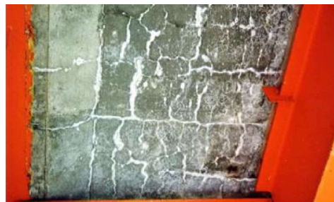
(2)格子状ひび割れと漏水，遊離石灰
