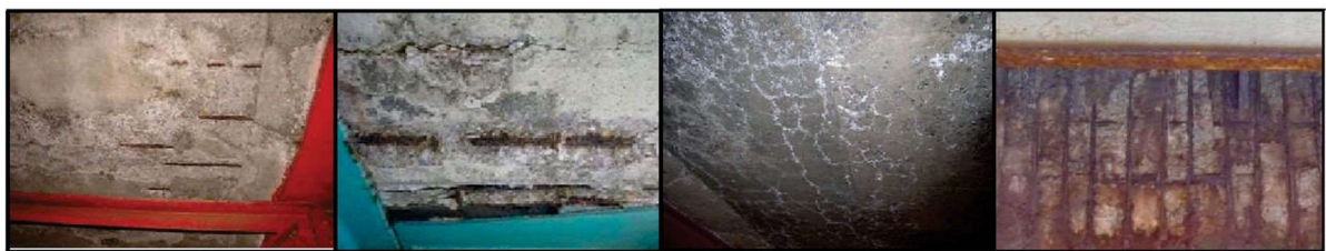
(1)鉄筋の露出 (2)ひび割れと 錆による剥落 (3)2方向ひび割れと 漏水・遊離石灰 (4)鉄筋の発錆による剥落（栈橋）
