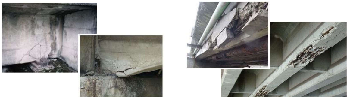
(1)主桁支点付近の損傷
