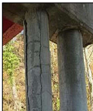
(1) パイルベントの損傷
