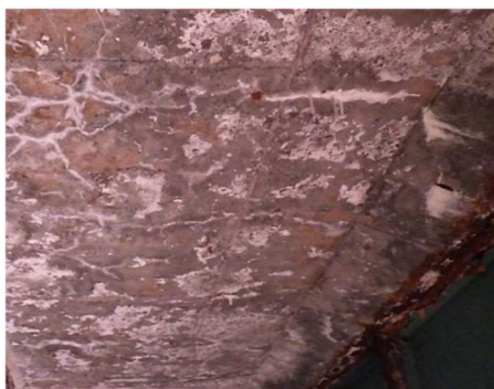
(1) 下面の損傷状況
