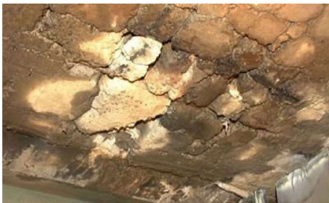
(1)格子状貫通ひび割れ
