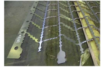
写真-3.1 展張状況 (ねじれ発生例)
