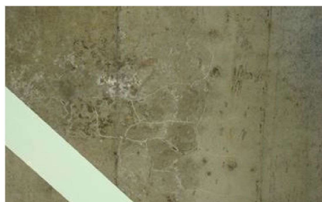
(2)漏水，石灰分の析出
