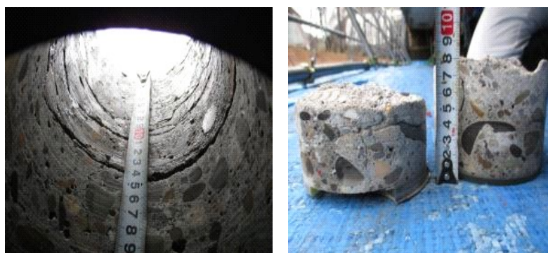
(1)コア内部の損傷 (2)水平ひび割れによる損傷
