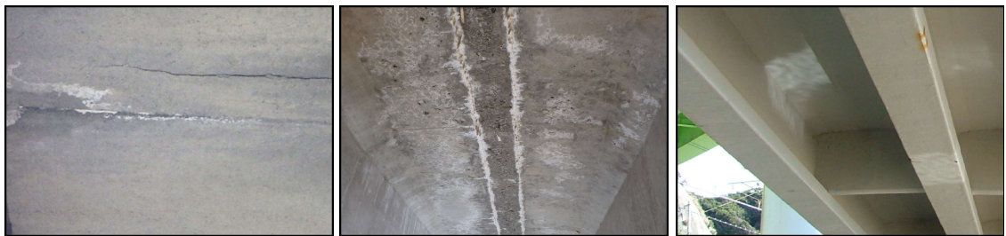
(1) 床版打ち継ぎ目の漏水
