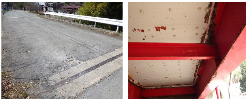
(1)橋面の損傷状況
