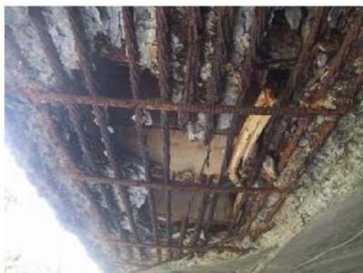
写真-6.1 峠部の道路橋の劣化事例
