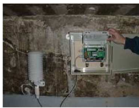
写真-3.21 箱桁内部の温湿度記録計
