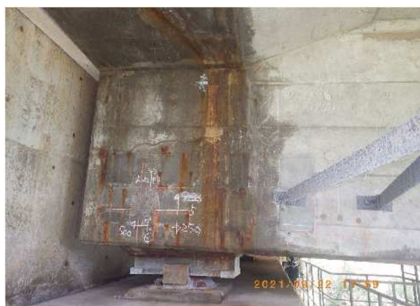
写真-6.2 桁端部の漏水による劣化
