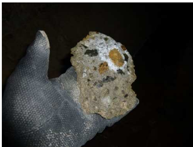
写真-2.6 骨材を核としたコンクリートの剥離
