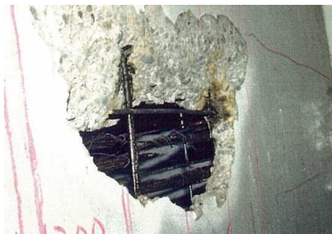
写真-2.3 水の浸入による鋼材の腐食
