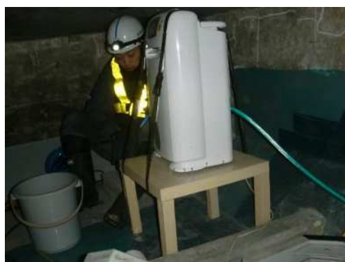
写真-3.20 箱桁内部の除湿機
