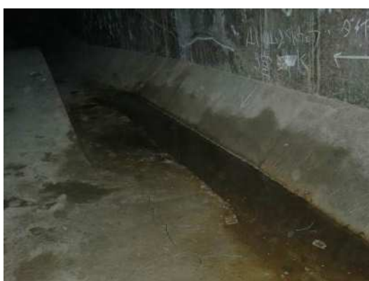
写真-3.8 箱桁内部の滞水
