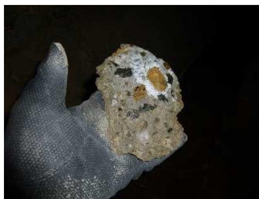
写真-3.9 コンクリート片の剥離
