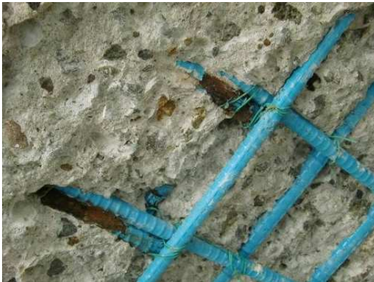
写真-3.15 スターラップ鋼材の腐食
