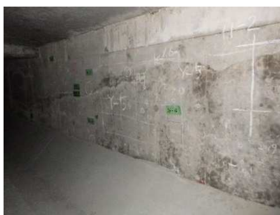
写真-4.6 上部構造箱桁内部 (粗骨材を核とした剥離の増加なし)
