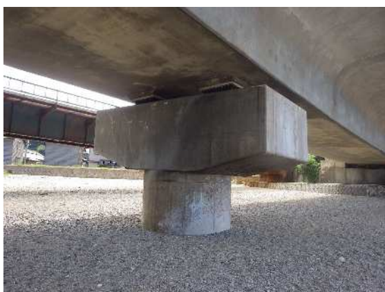
写真-5.13 P2 橋脚状況(波の衝突による剥離)
