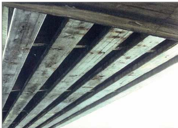
写真-2.1 竣工から 15 年目(1980 年)の劣化状況
