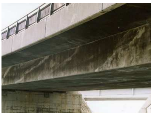
写真-1.5 上部構造のコールドジョイント
