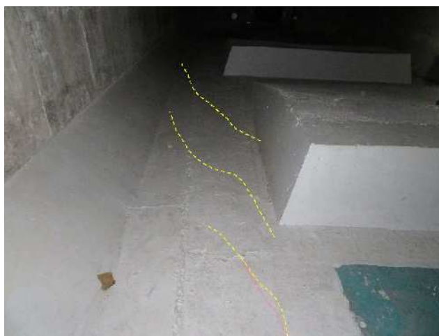
写真-4.15 下床版上面のひび割れ状況
