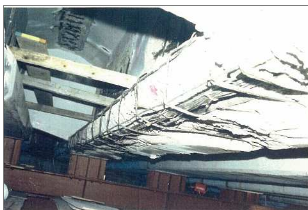
写真-2.2 竣工から 2 年目(1967 年)の劣化状況
