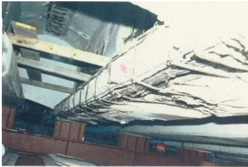
写真-3.2 架替え以前に架かっていた旧橋の損傷状況
