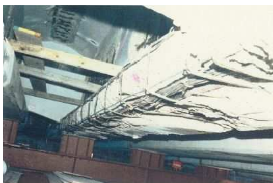
(a) 上部構造主桁の劣化状況
