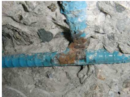
写真-3.16 鉄筋交差部の腐食
