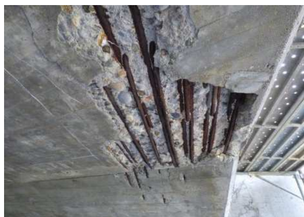
写真-6.3 路面から回りこんだ水による劣化
