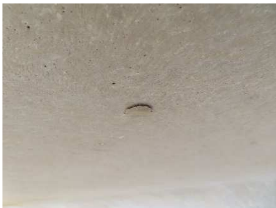
写真-5.9 張出し床版の剥離
