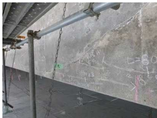
写真-3.7 コールドジョイント
