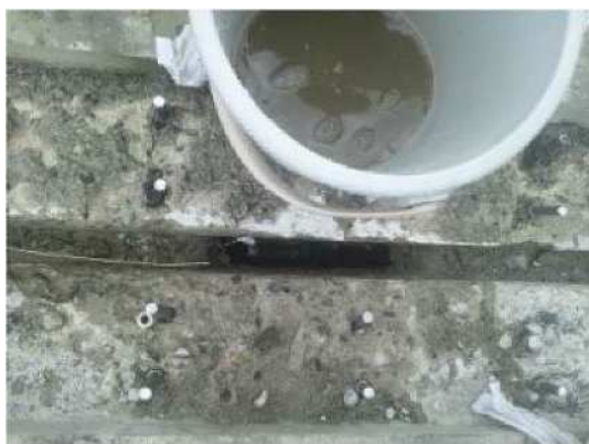
写真-3.18 上部構造端部の桁遊間の滞水状況
