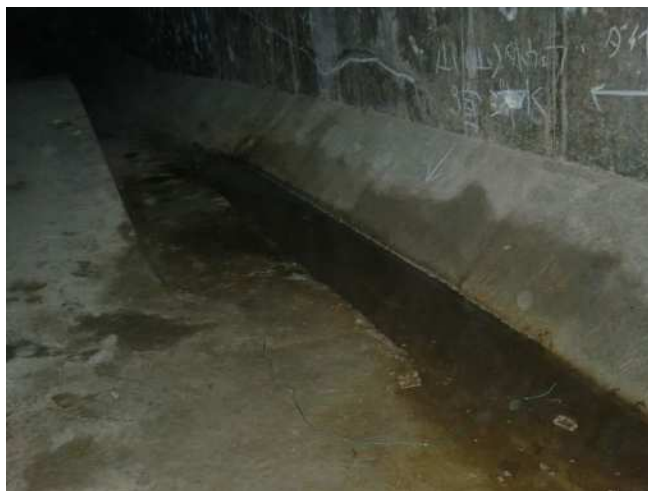
写真-2.5 箱桁内部の滞水
