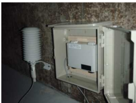
写真-4.13 箱桁内部の温湿度計
