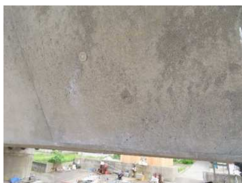
写真-5.19 主桁ウェブの剥離
