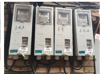
電気メーター
