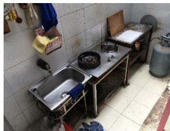
増築キッチンのガスボンベ
