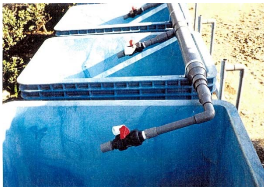
① 水槽注水部
