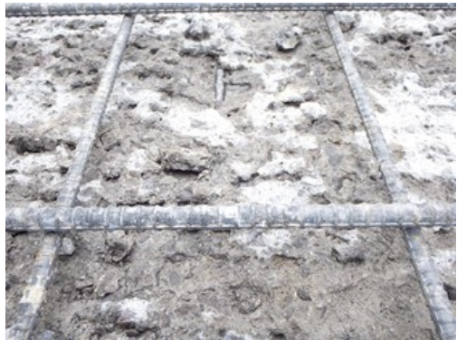
写真-3.3.4 内部鉄筋の外観
