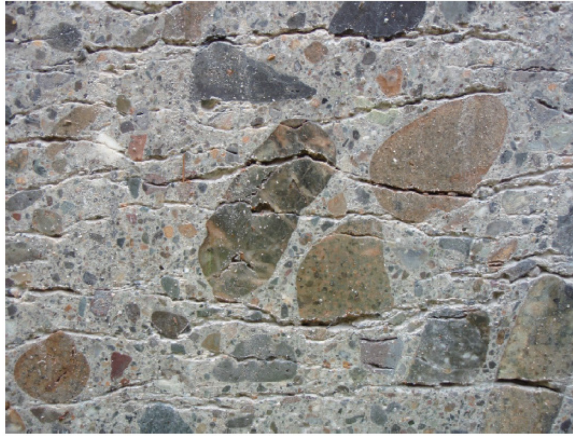
写真-2.2.3 RC床版切断面の多数の水平ひび割れ
