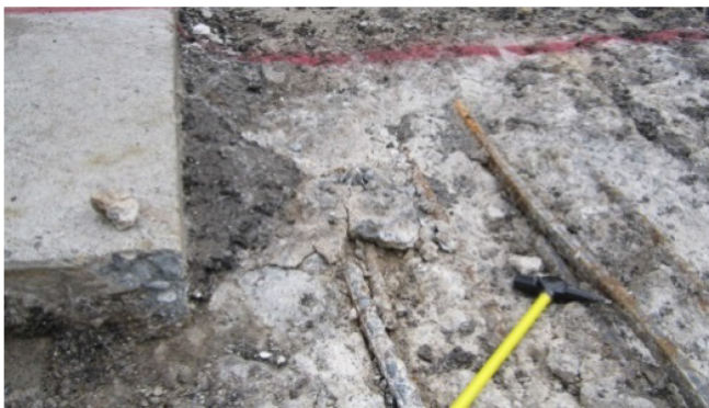
写真-2.2.1 露出した鉄筋
