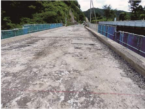
写真 1.1.1 ASR 劣化した RC 床版の舗装切削後 19)
