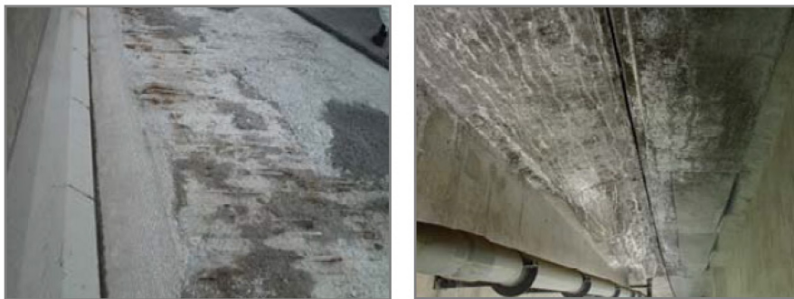
写真-2.2.4 檜山橋の一次床版の劣化状況(左:上面, 右:下面)
