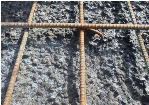
写真-5.4.3 内部鉄筋の外観
