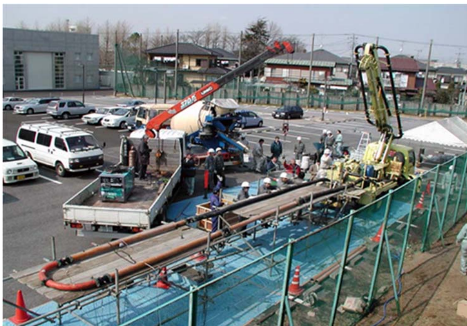
写真 6-1 試験圧送の配管経路の一例
