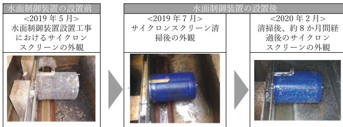
写真 6.17 水面制御装置設置前/後のサイクロンスクリーンの外観
