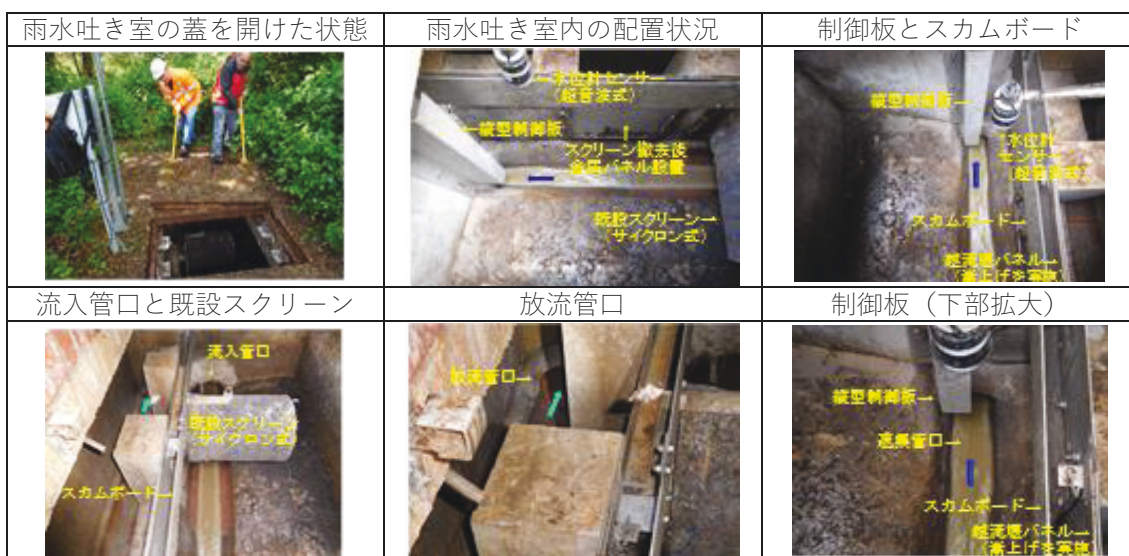
写真 6.16 実証実験における水面制御装置の設置工場の状況
