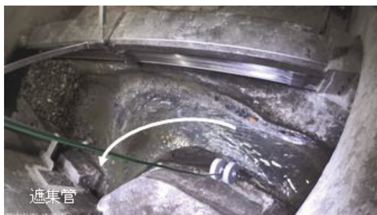
写真 6.5 遮集管に吸込まれる浮遊物 (ケース A)
