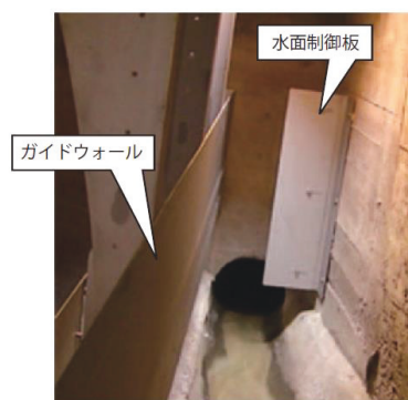
写真 6.20 ドイツ・水面制御装置の設置状況(写真 6.19 同様)
