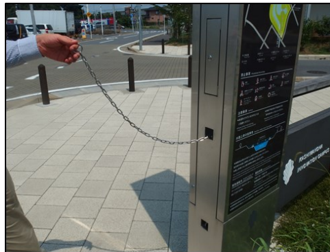
写真3-11. チェーンによる大雨時の立入禁止措置 2 (調整池 No. E1 北部中央 2号調整池)
