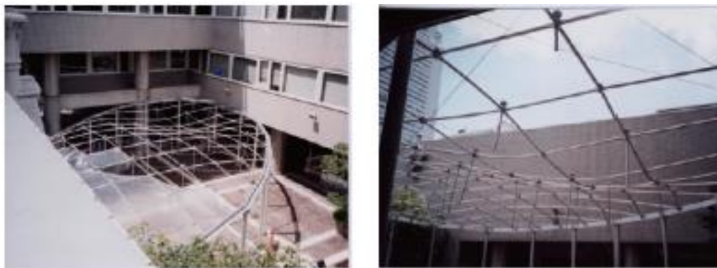
写真4. 2. 1 仮設建築物の崩壊
