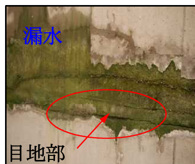
(4) 目地部周辺の漏水 (頂版)
