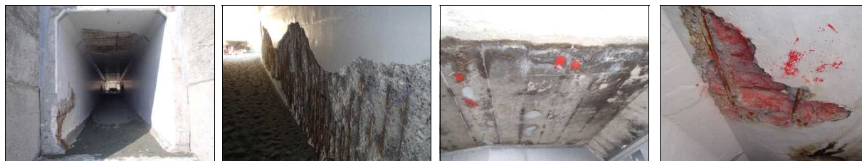
(1) 全景 (2) 側壁のはく離 (3) 頂版の漏水 (4) 頂版鉄筋の錆
