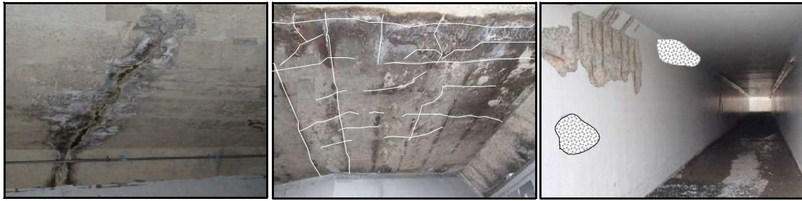
(1) ジョイン部の漏水 (2) 頂版のひび割れ (3) コンクリートはく落
