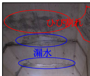
(2) ひび割れと漏水
