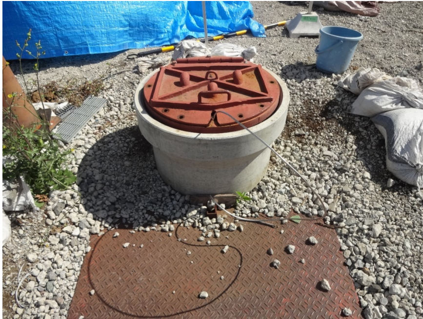
(a)ピットの外観
