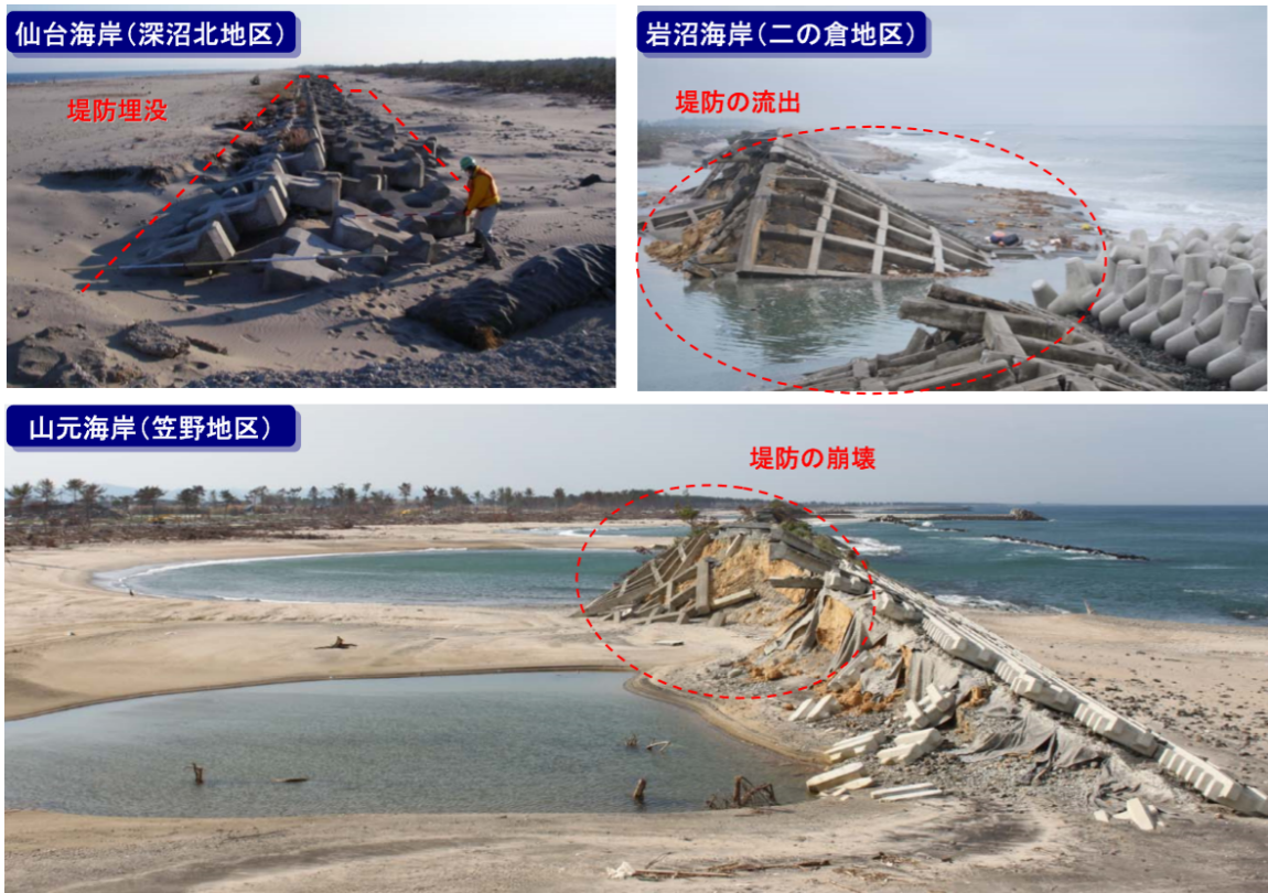
図 1.36 津波による海岸堤防への影響 [55]
