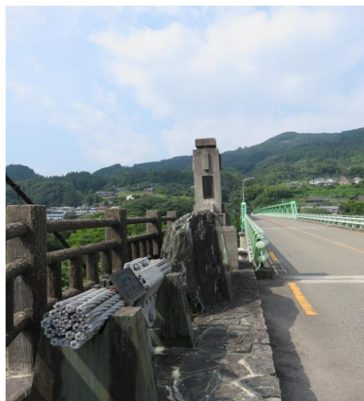
写真 6-6 切断ケーブルと親柱
