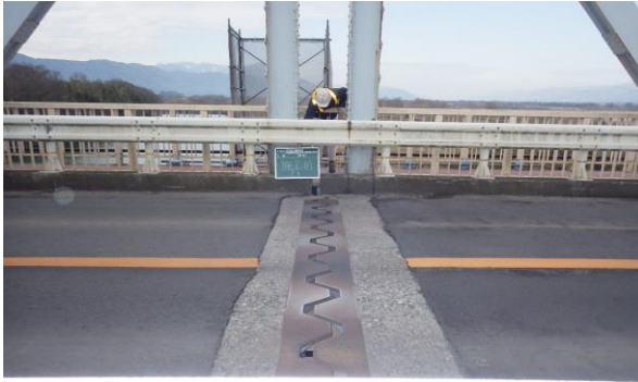
写真 6-12 伸縮継ぎ手補修前
