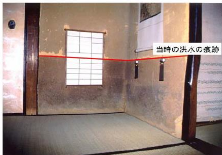
写真2-1 蔵珠院（国府町）（出典：国土交通省『吉野川水系河川整備計画』P.9） 慶応2年8月「寅の水」洪水の痕跡 周囲の畑から3mの高さになる。
