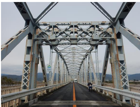
写真 6 - 1 0 再塗装前状況
