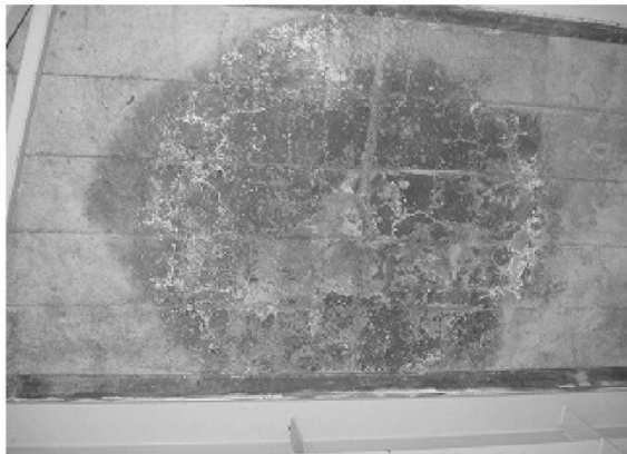
床版下面に、ひびわれに沿った遊離石灰や変色が見られる。
