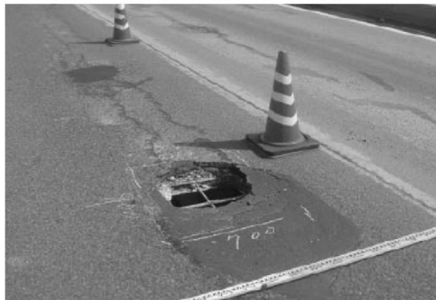
上記損傷が見られた橋梁では、床版の抜け落ちが発生した。
