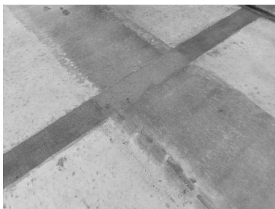
(i) 床版上面の状況
