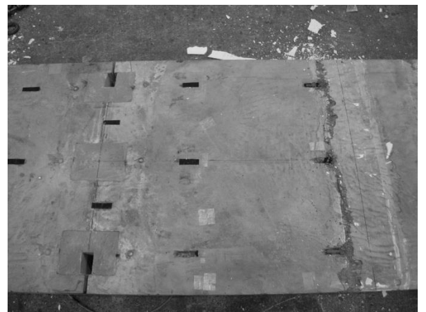
接合部付近（実験終了後）
