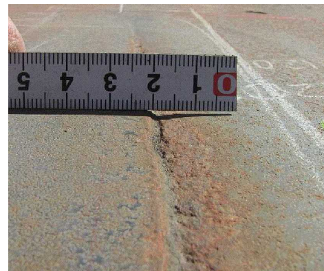
(4) き裂発生による段差
