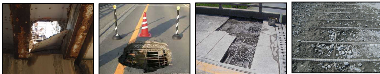
(1) 凍害による損傷事例
