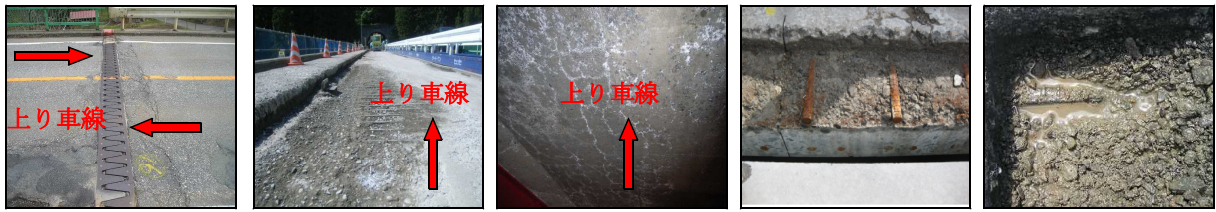
(1) 伸縮継手 (2) 上面損傷 (3) 下面損傷 (4) 土砂化 (5) 雨水の滞水 写真－ 5.1 積雪寒冷地域の RC 床版の損傷状況（上り車線）
