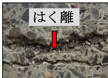
写真－ 3.6 界面のはく離
