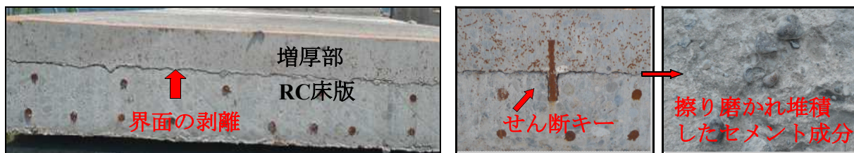
(1) 増厚界面のはく離 (2) せん断筋 (3) 界面のノロ
