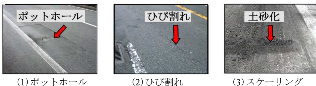
写真－ 3.1 RC 床版の損傷状況の一例
