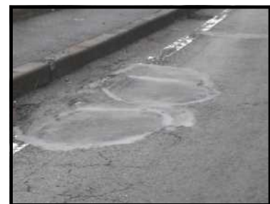
写真－2.5 舗装の異常
