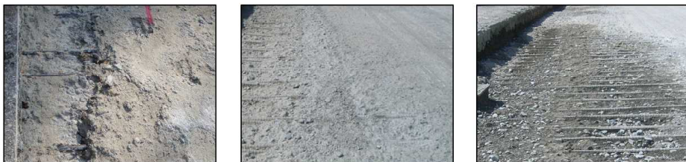
(1)塩害による鉄筋の腐食 (2)凍害によるスケーリング (3)土砂化
