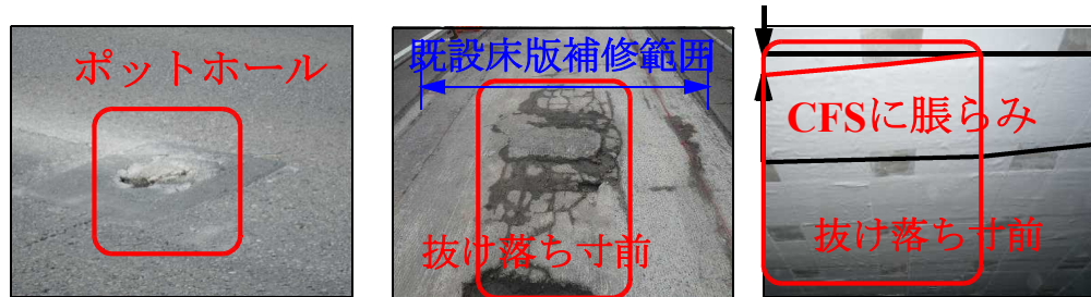
(1)ポットホールの発生 (2)補修箇所の再劣化 (3)CFS の脹らみ
