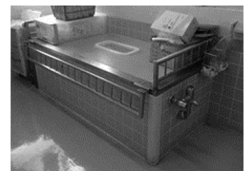
写真 7-16 便器周辺かさ上げトイレ例
