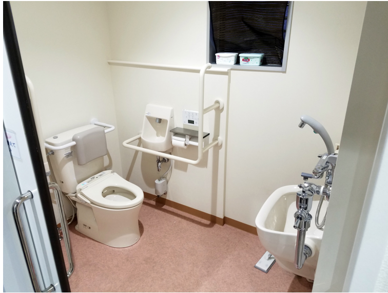
写真 5-5 車椅子利用者にも対応した多機能トイレ（A施設）
