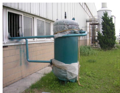
図 5.3.10 圧力空気タンク
