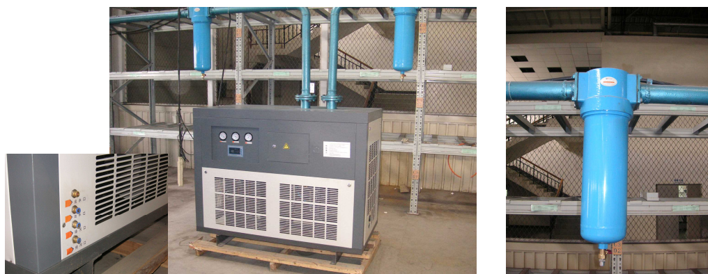
図 5.3.6 湿気除去装置本体と配管用湿気除去装置
