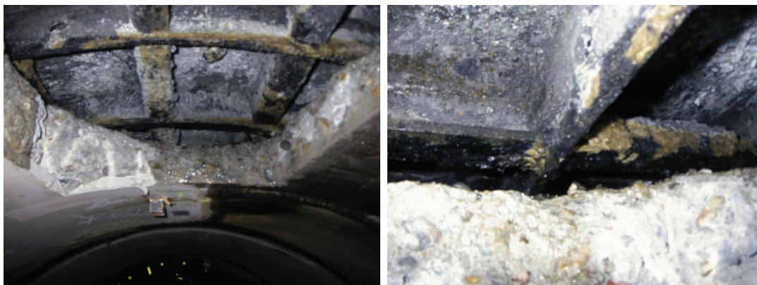
写真5.3 測定結果より空隙が存在すると判断された位置での内部状況
