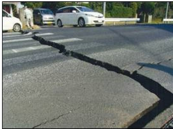
写真-2.4.1 東日本大震災により発生した路面段差
