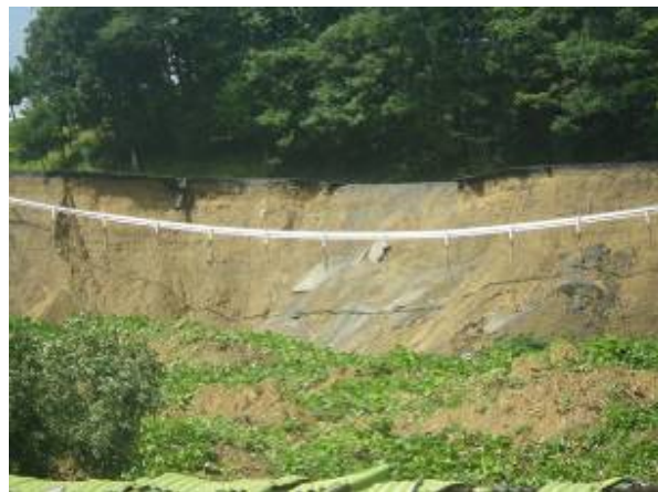
写真-2.4.2 関東・東北豪雨により崩壊した道路盛土
