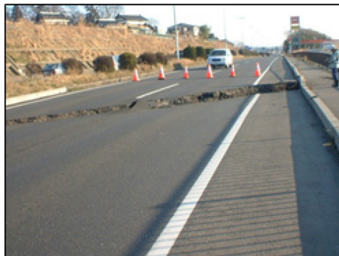
写真-1.2.1 東日本大震災により発生した路面段差(H24.3)
