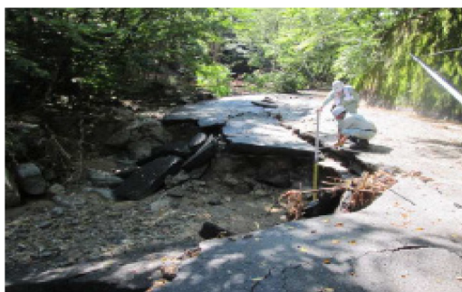
写真-5.4.2 関東・東北豪雨で壊滅的被害を受けた道路と TEC-FORCE としての活動状況
