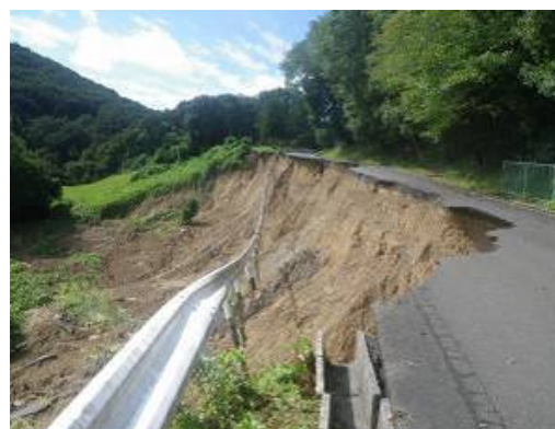
写真-1.2.2 関東・東北豪雨により崩壊した道路盛土(H27.9)
