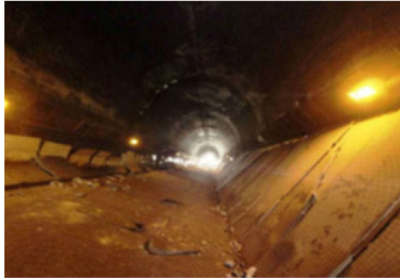
写真-1.2.3 中央道笹子トンネルの天井板崩落事故 (H25.12) 5)
