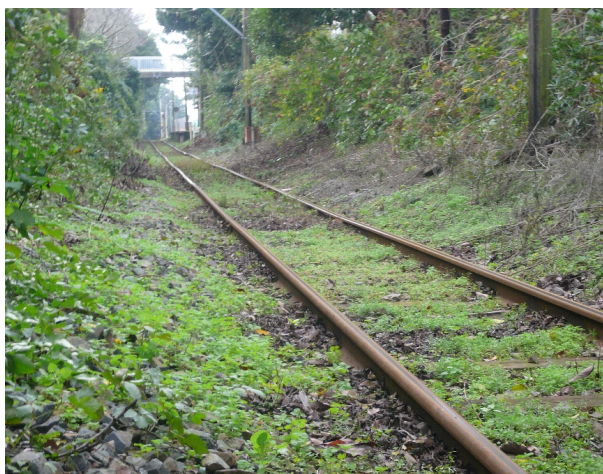
図 4.5.6: 目視可能な軌道不整
