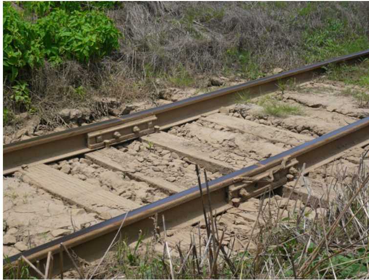
図 3.2.7: 浮きまくらぎ
