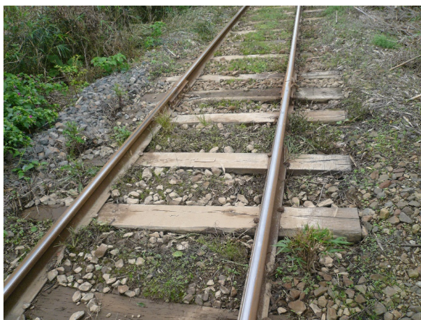
図 4.5.3: 浮きまくらぎ
