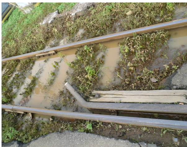
図 4.5.5: 軌道上に溜まる雨水（積泥区間）
