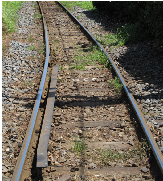
図 4.5.11: 角折れの状況
