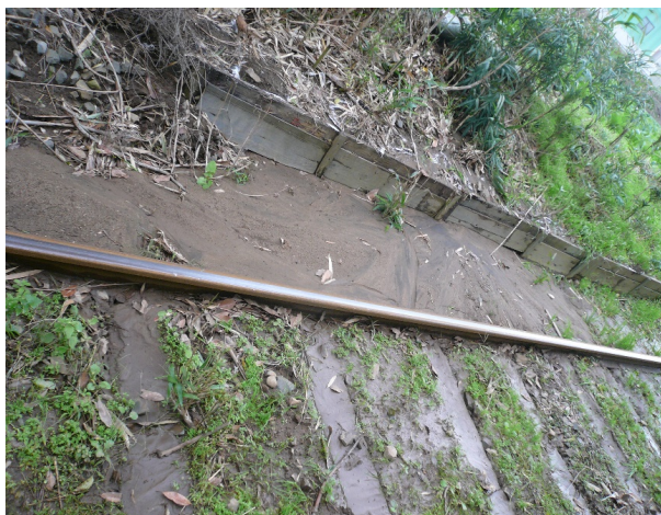
図 4.5.4: 線路脇より流入する土砂
