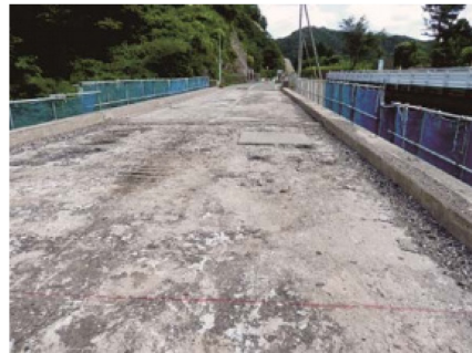
写真-2.2.3 ASR 劣化した RC 床版の損傷事例 16)
