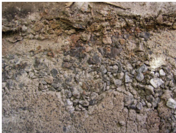
写真-2.3.2 床版コンクリートの砂利化 30)
