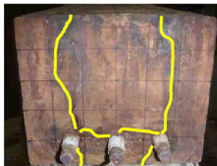
写真-3.5.2 錆汁の発生状況 13) (電食試験)
