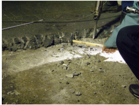
(a)床版上面のスケーリング
