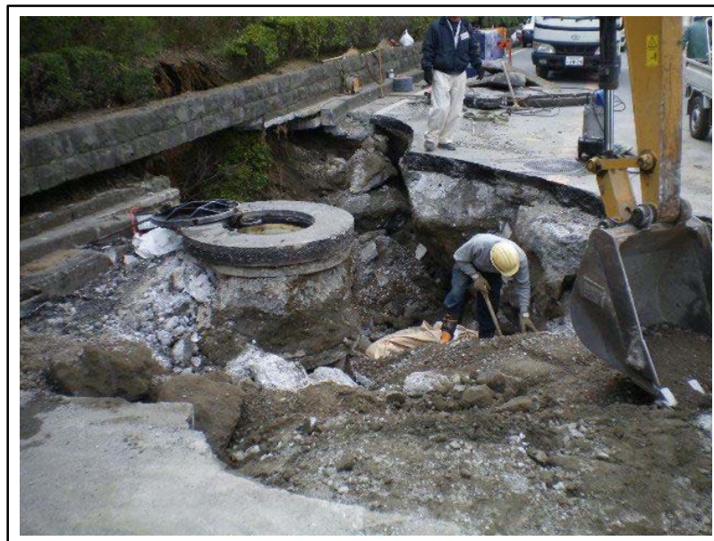
写真-1.1.3 東日本大震災での下水道破損による道路陥没の例（習志野市）
