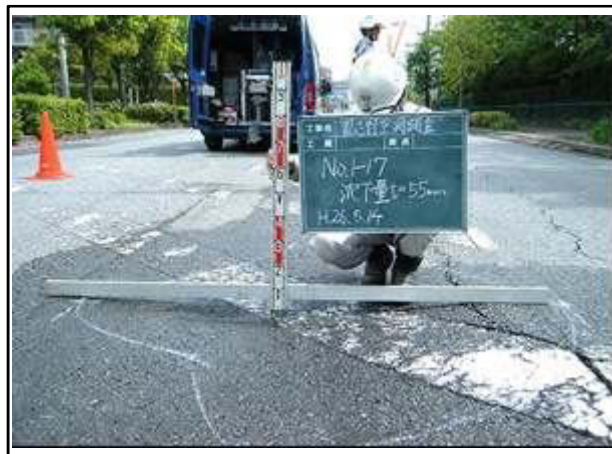
写真-1.2.1 ゆるみによる路面の沈下 7)
