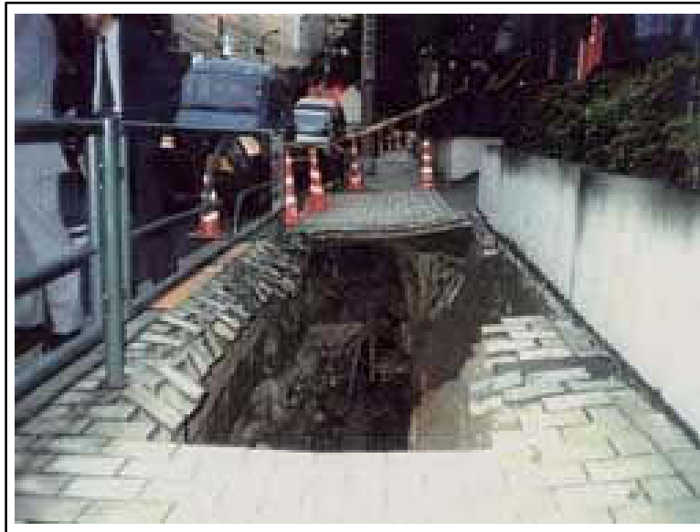
写真-1.1.2 下水道管渠老朽化による道路陥没の例（東京都） 5)
