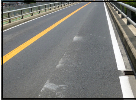
(1) 舗装に遊離石灰の発生
