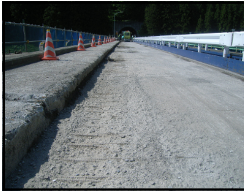
(1) スケーリングおよび土砂化
