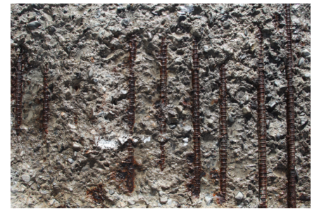
写真－ 5.4 スケーリングおよび発錆状況
