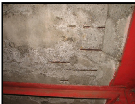
(1) 鉄筋の露出と漏水
