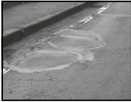
写真－ 2.5 舗装の異常の一例
