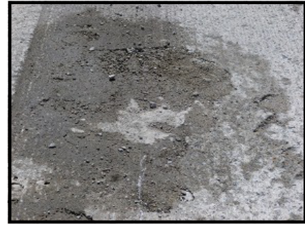
(2) RC床版上面損傷
