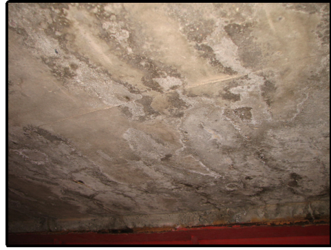
(2) 漏水・遊離石灰・錆の発生
