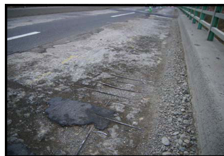
写真－ 2.4 床版の上面損傷
