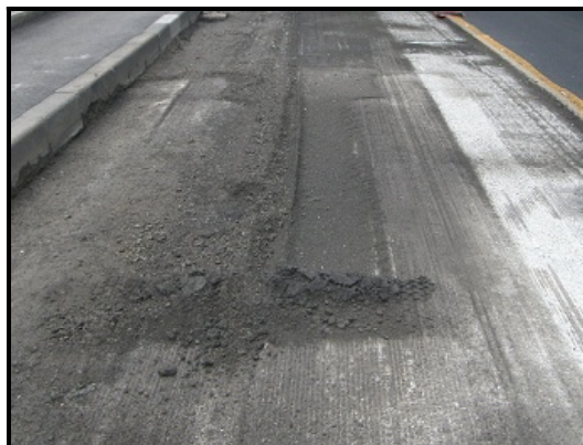
写真－2.8 RC床版上面の損傷事例
