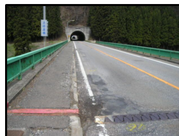
(2) 舗装面の損傷状況
