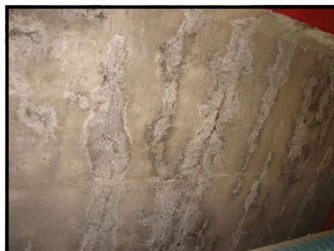
(2) 漏水と錆汁の沈着
