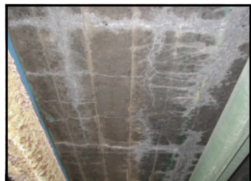
(2) 2方向ひび割れと遊離石灰
