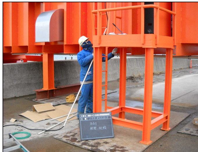
外部配管・配線状況
