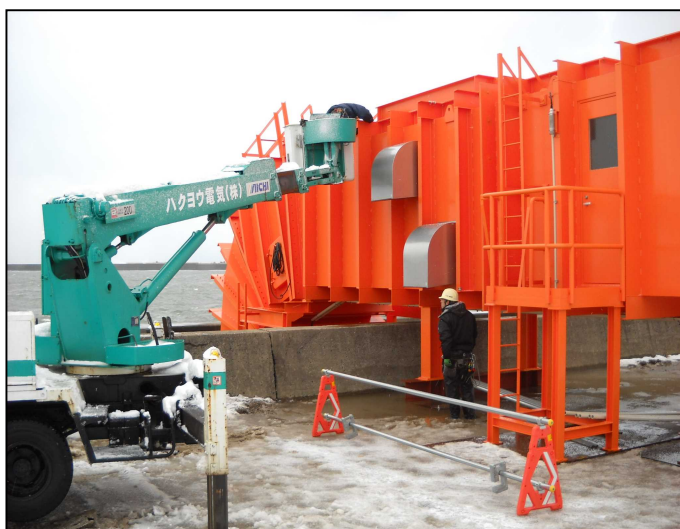
外部配管・配線状況
