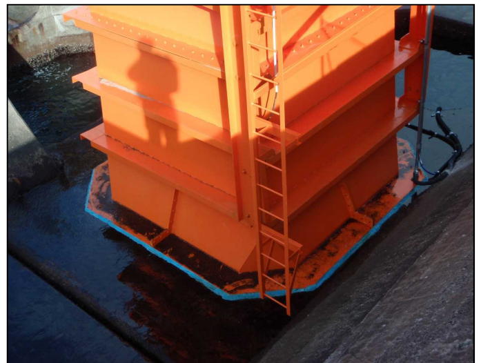
基部取付部コーキング状況(青色箇所)
