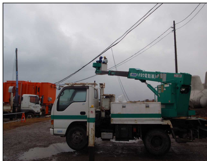
電気室-計測室配線状況
