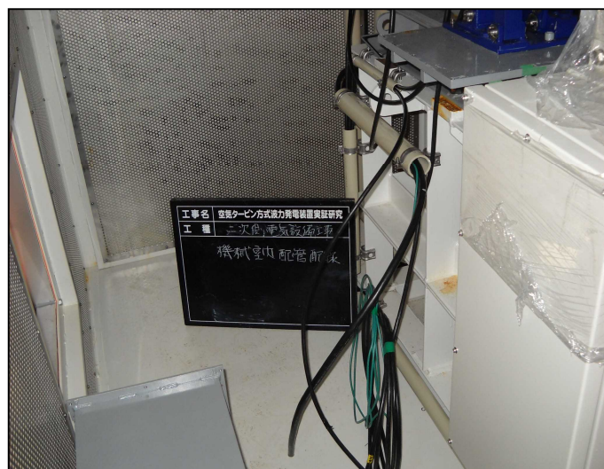
機械室内配管・配線状況
