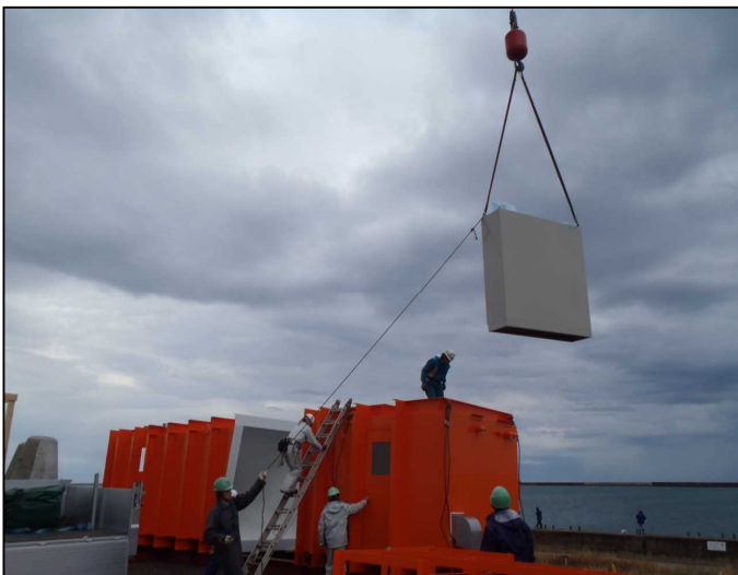
電気制御盤設置状況
