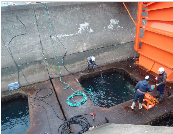
ケーブル配線状況
