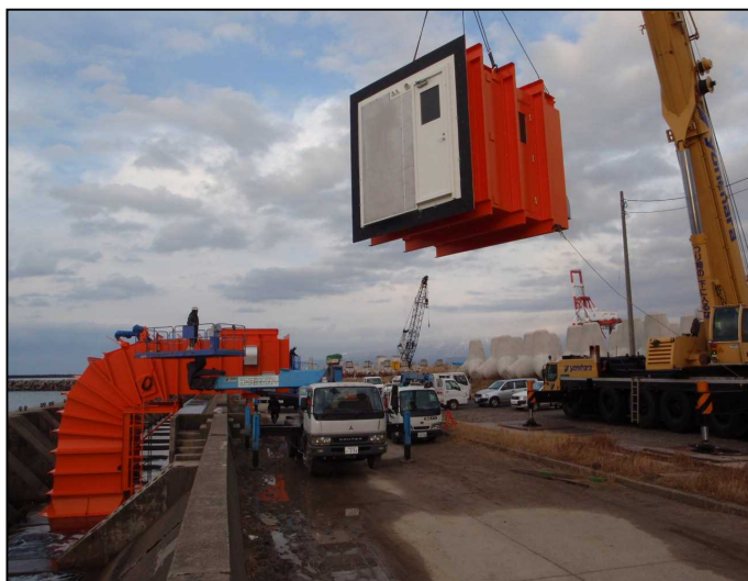
電気室設置状況
