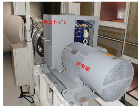
タービン発電機ユニット
