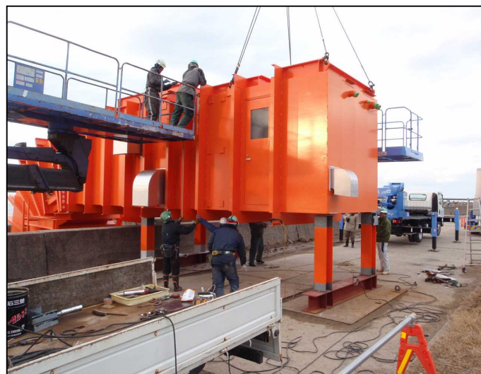
電気室設置状況
