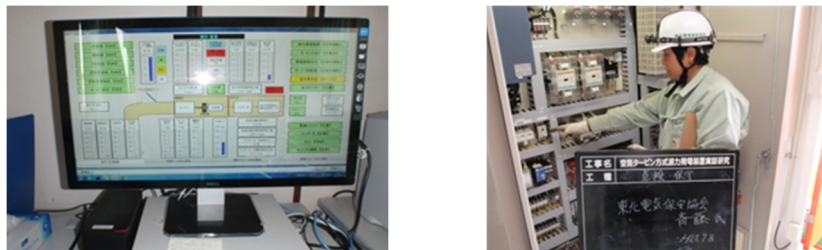
写真 8.6 電気制御設備状況
