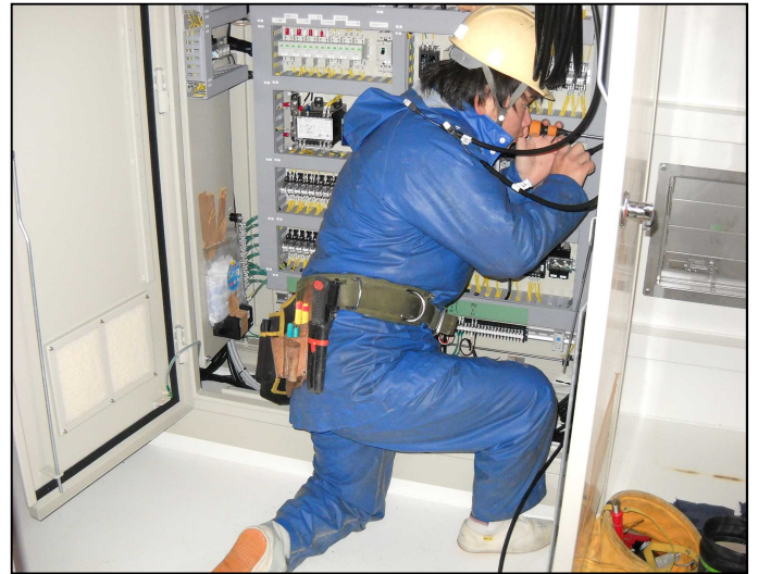
電気室制御盤配線状況
