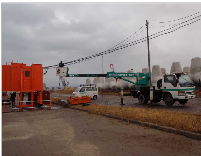
電気室-計測室配線状況
