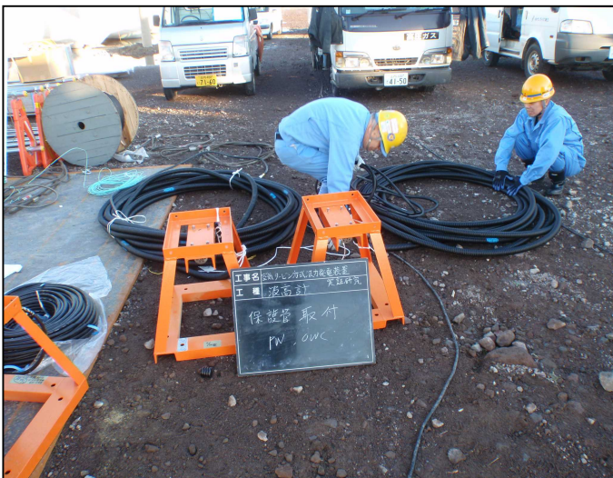
波高計保護管取付狀況
