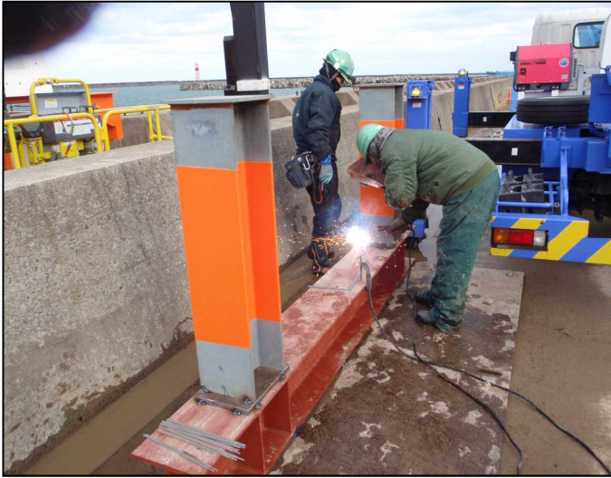
サポート取付状況
