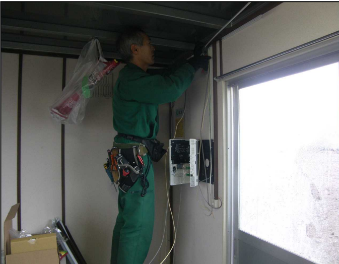
計測室防犯対策・セコム設置状況
