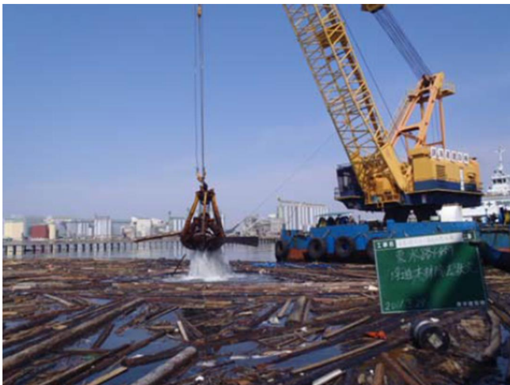
図-2.1.4 浮遊障害物の状況 3) (石巻港)
