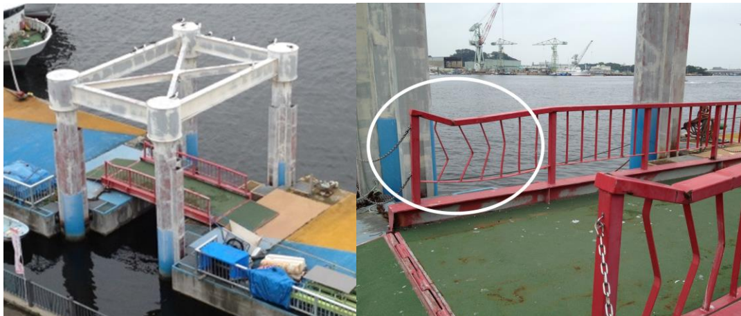
図-4.2.2 マリングート塩釜の浮棧橋連結部及び係留杭の構造と手すりの被害
