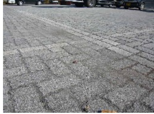
沈下による水たまり跡
