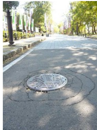
マンホール周辺舗装ひび割れ
