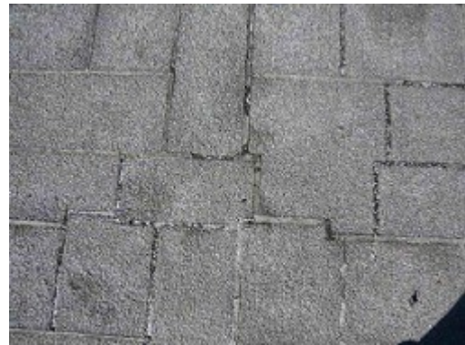
目地モルタル破損
