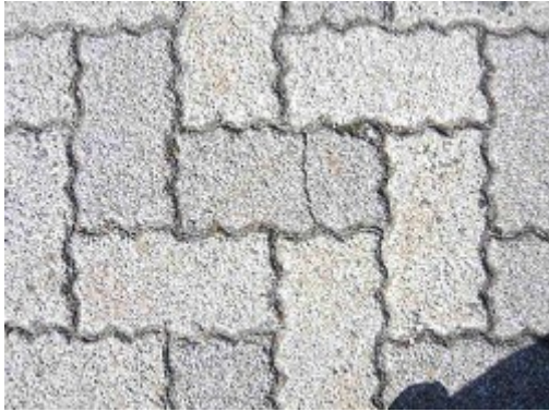
ブロック割れ
