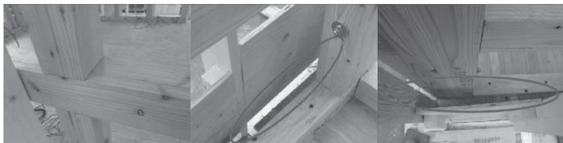
a) 相欠接合部 b) 格子と壁の隙間 c) 室内壁の凹部の形成跡
