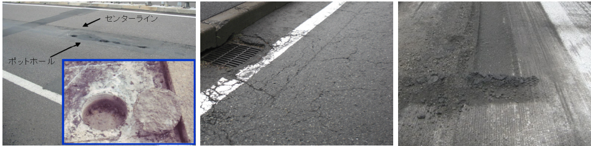
(1) ポットホール (2) ひび割れ (3) スケーリング
