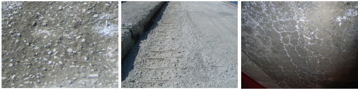
(1) 床版上面の骨材露出 (2) かぶりコンクリートのスケーリング (3) 遊離石灰の発錆
