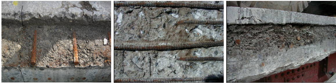
(4) かぶりコンクリート (5) 融雪剤散布による塩害 (6) 圧縮鉄筋まで砂利化の砂利化
