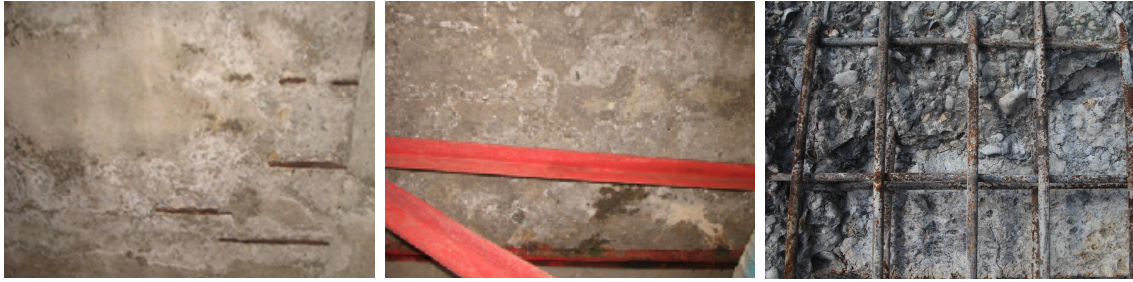
(1) 鉄筋の露出 (2) 錆汁の沈着 (3) 内部鉄筋の発錆 写真－ 2.2 海岸線付近の重要路線に建設された RC 床版の損傷状況 2.6), 2.15)
