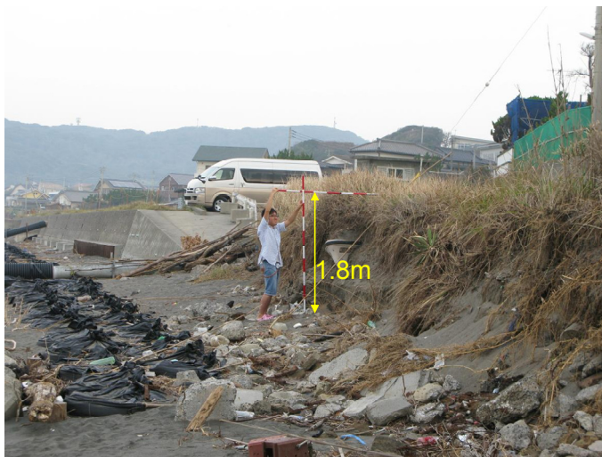
図 2.5.6 突堤背後部での侵食状況
